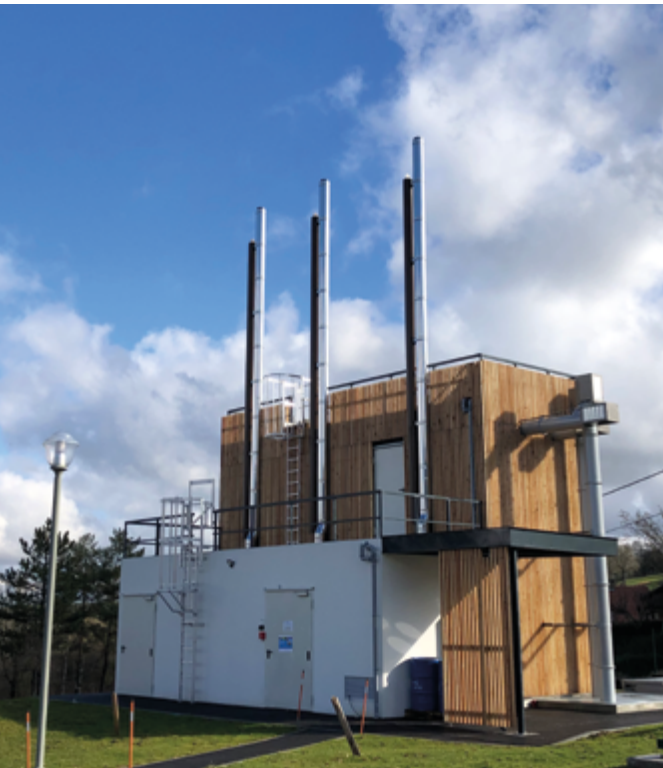
Chaudière bois EHPAD de Mamirolle (Doubs)
